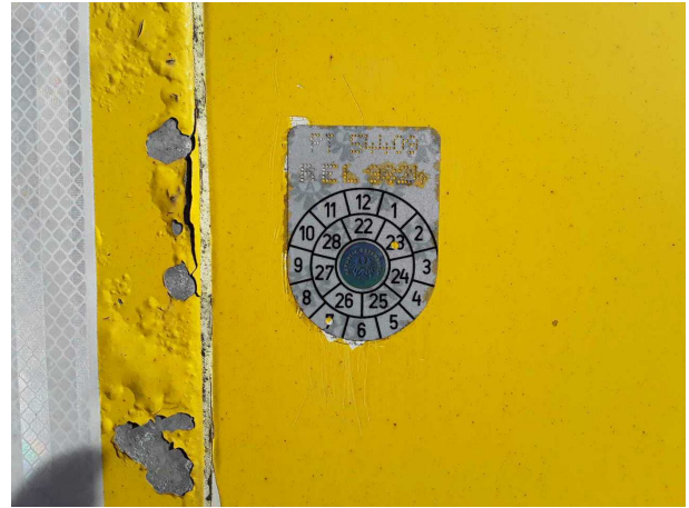
Beschädigung 3: Sonstiges: Hauptuntersuchung - fällig - durchführen
