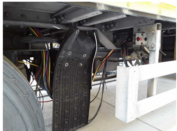
Beschädigung 4: elektronische Systeme: elektronische Systeme (Kostenfolgen möglich) - defekt - instandsetzen
